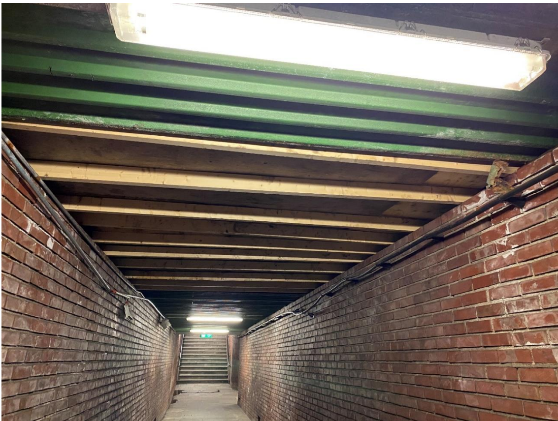
Bilde 12: Bilde viser rampe 2C hvor taket er byttet ut på grunn av korrosjon. (1)
