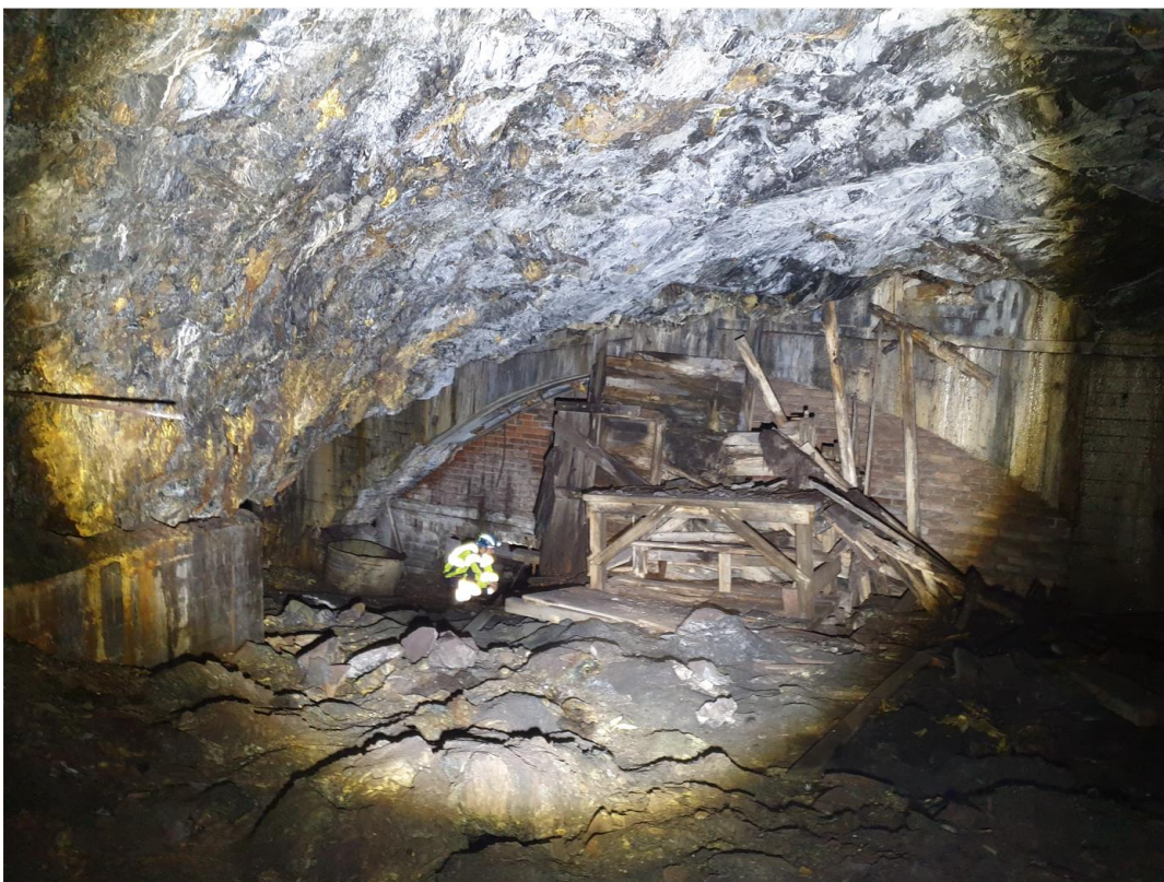
Bilde 13: Bilde viser Heibergløkka tverrslag sett mot plattform 2. Det er en god del nedfall av sterkt forvitret bergmasse på tunnelsålen.
