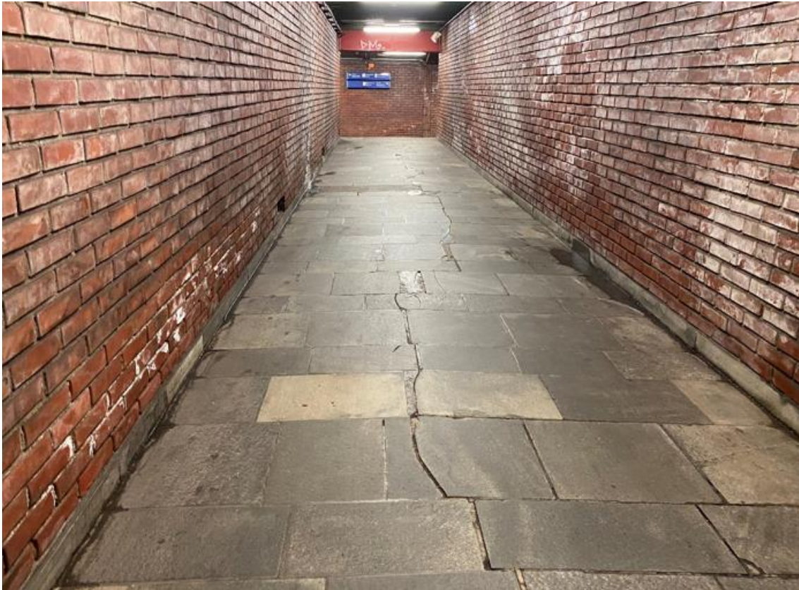
Bilde 11: Bilde viser svelleskader på gulvet rampe 2C. Fukt på veggene. (1)
