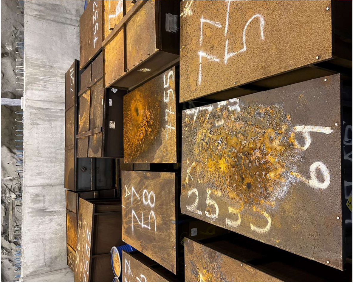
Tønner og kasser som ikke var støpt inn. Avvik 4
