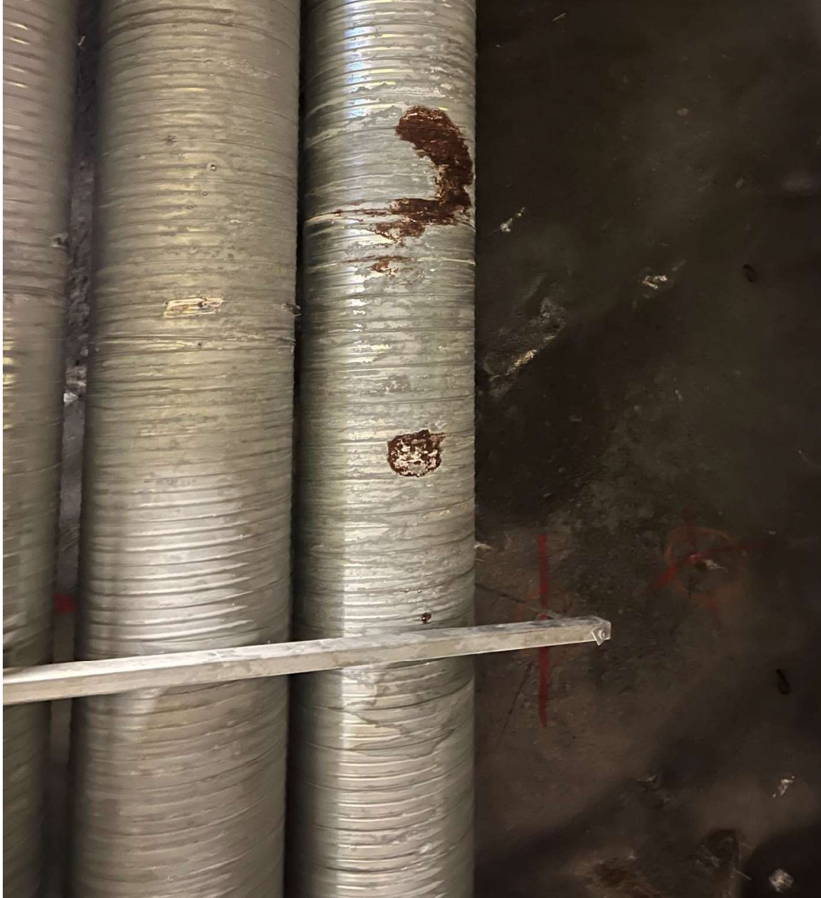
Utstående vedlikeholdsbehov i ankomsttunnelen. Rustangrep på ventilasjon og feil på belysning. Aavik 2
